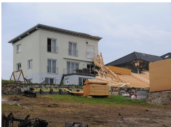
Unwetter in Weilbach – Sturm fegt Dach weg
