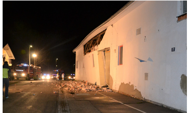
Gebäudeeinsturz in Ried i.l.
